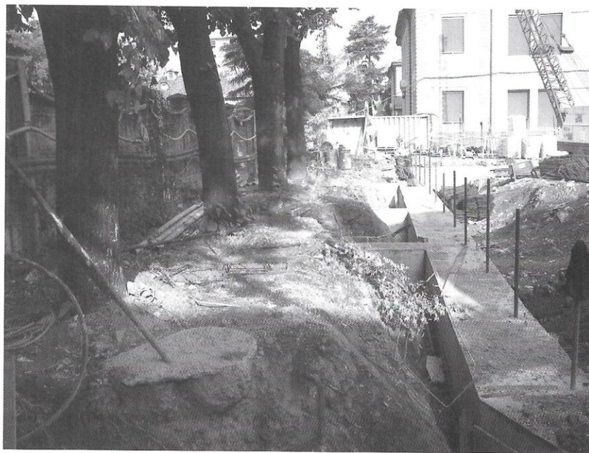
Fig. 4 – Gli interventi edilizi spesso sono causa di danni disastrosi agli alberi esistenti (ristrutturazione area ex veterinaria in via Belmeloro a Bologna)
