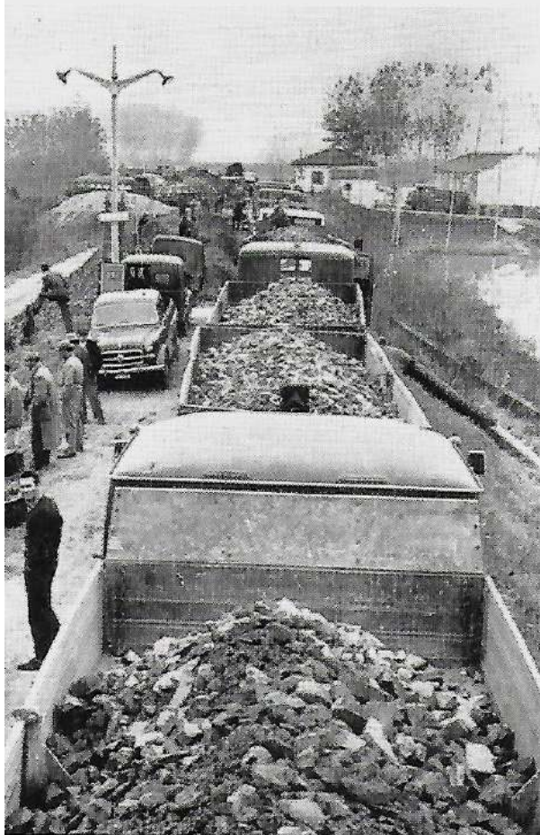
Fig. 6. - Rotta del Po di Goro a Torre di Rivà. Costruzione di una coronella per tamponamento. Servizio di autocarri per trasporto di pietrame.
