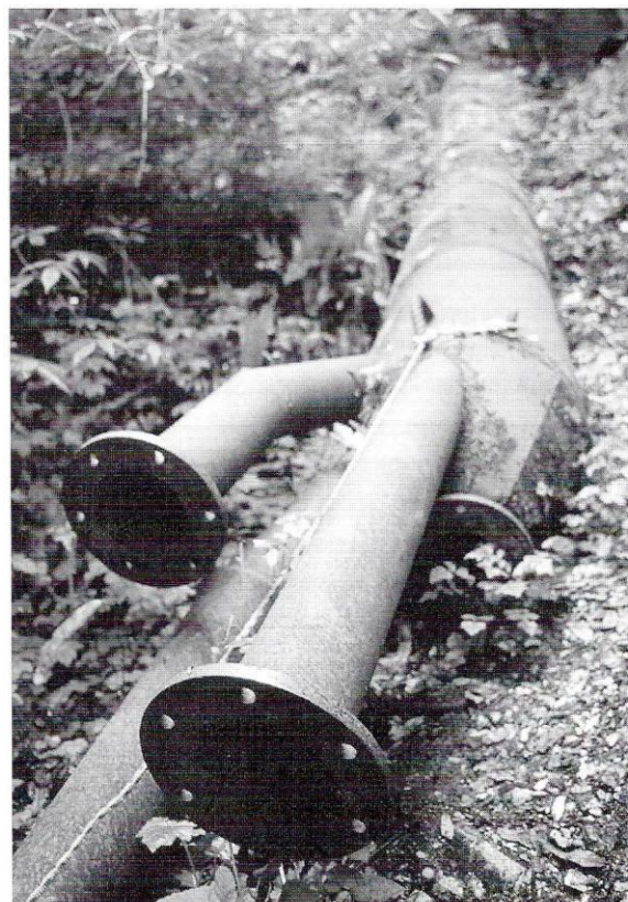
Fig. 13 - Particolare delle vecchie infrastrutture utilizzate per le prove di captazione delle acque (Foto M. Giardini).
