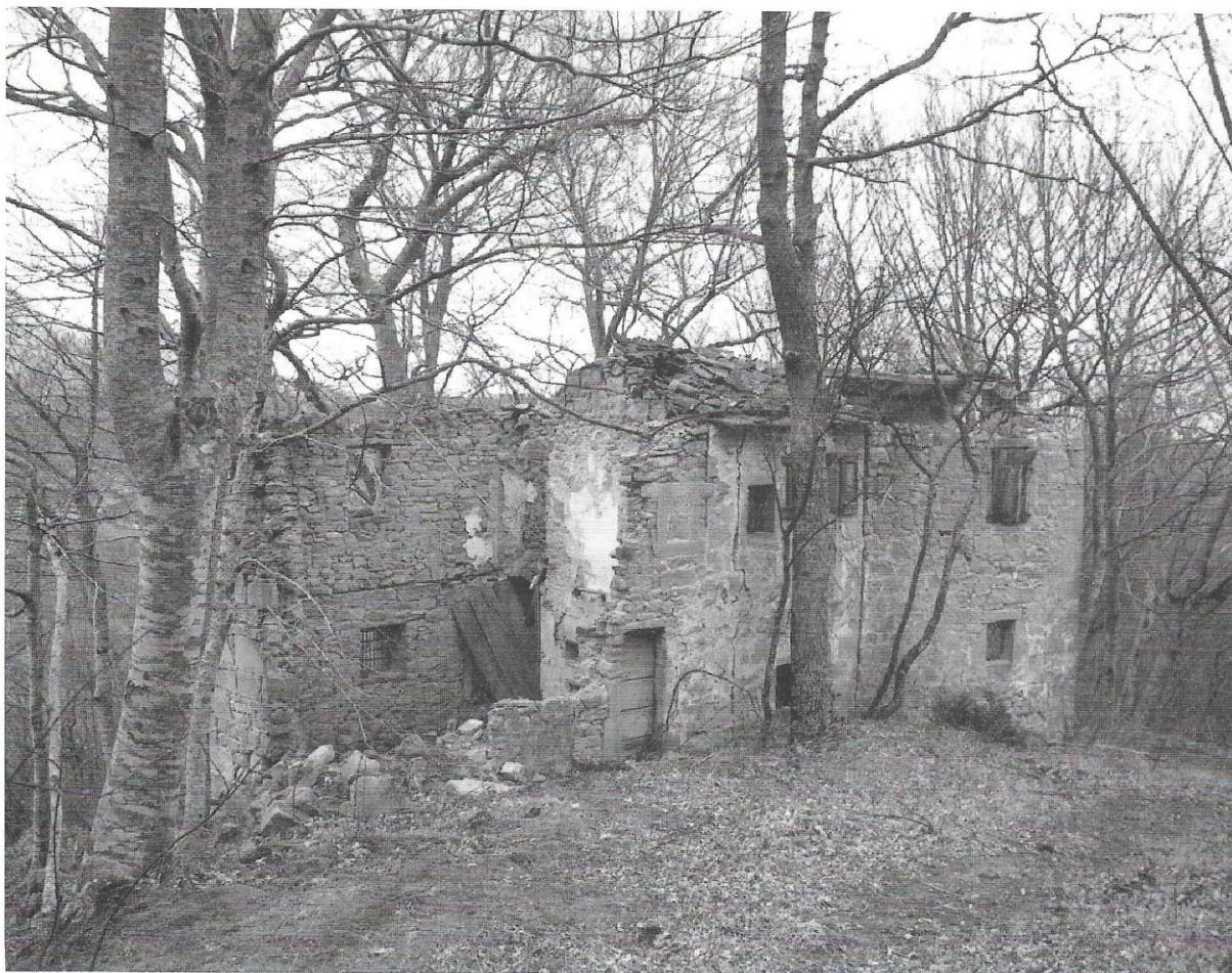
Casa di caccia in evidente stato di degrado e semidiroccata.
