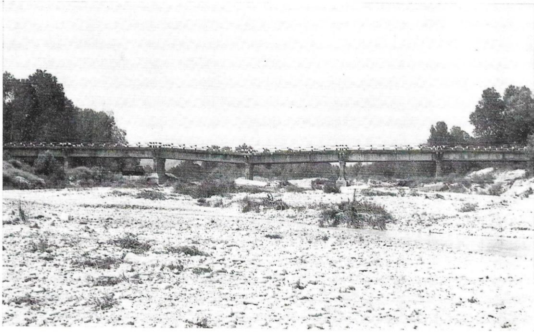
Il ponte sul Tavo della strada Cappelle - Città S. Angelo: il cedimento dei piloni è stato provocato dal massiccio prelievo di ghiaia.
