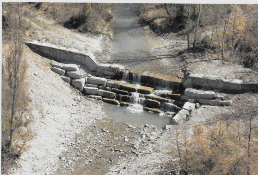
Figura 9 - Le briglie permettono di ridurre la pendenza dei corsi d'acqua montani limitando drasticamente i fenomeni erosivi
