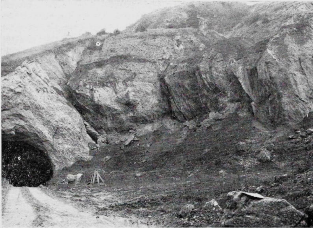
Fig. 1 - Scavo in galleria e dissesto per crollo sulle pendici del Monte Capra.
