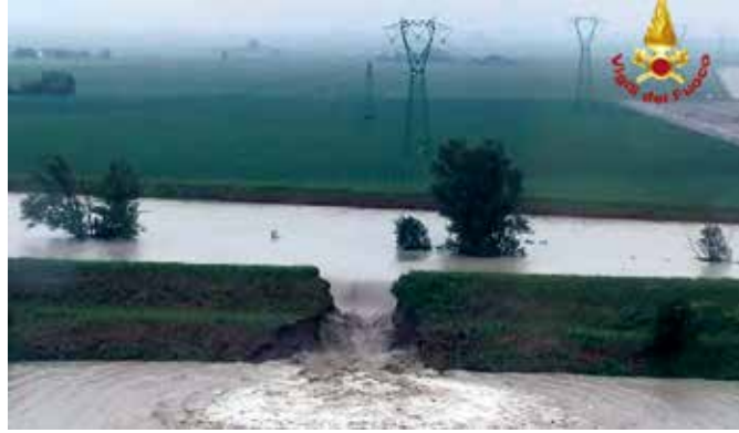
Fig. 6 – Rotta arginale del 2 maggio 2023 del torrente Sillaro a Spazzate Sassatelli, Via Merlo (si noti il filare alberato d'alveo dove l'argine era alto 7 m) (Foto Vigili del Fuoco).
